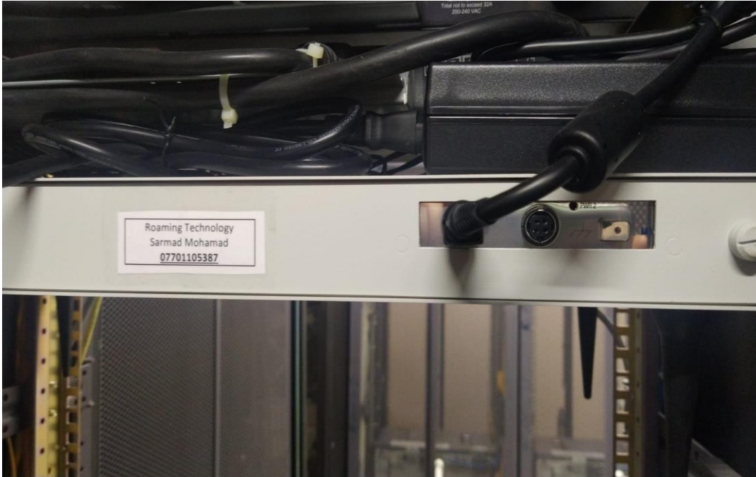
Mosul data center
